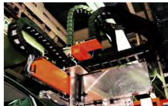
Trzy - wyposażone w specjalne przewody firmy igus® - systemy zasilania w kilku osiach. e-przewodnik: System E4/00 i System E4/0
