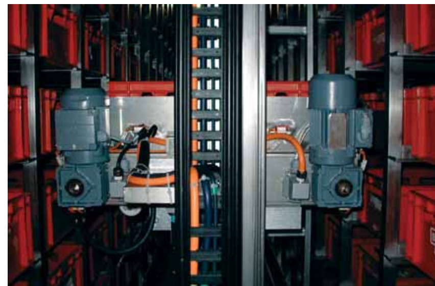
Przewód sterowniczy CF10 w układarkach regałowych. e-przewodnik : System E2 medium
